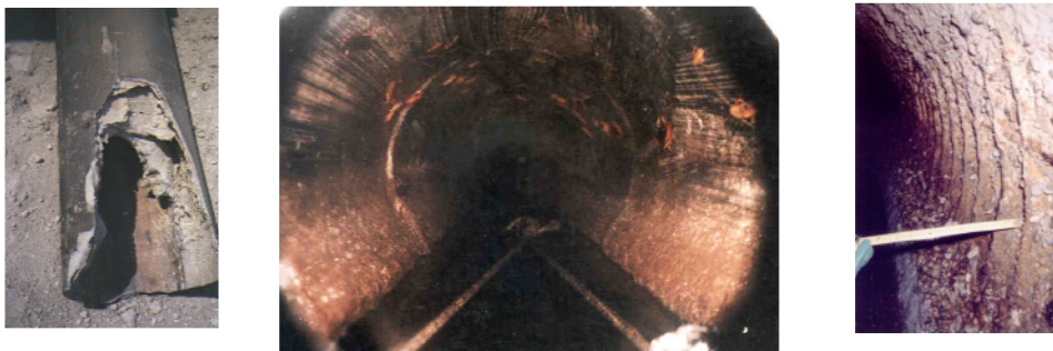
Фиг. 8: корозия на азбесто-циментова тръба (ляво), корозия на бетонни тръби с покритие (в средата), корозия на бетонна тръба > 2 см дори зад арматурата (дясно).
